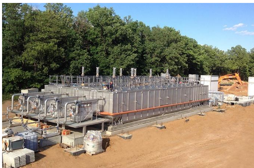
Канализационные очистные сооружения Иннополиса (основное оборудование)
