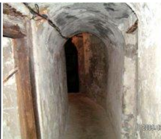
Состояние коридоров и подземных келий в период выполнения работ по инженерной защите Гефсиманского Скита
